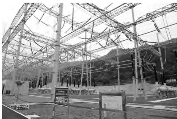
500千伏望嘉变建成投运
